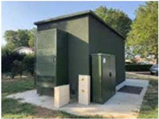
NŒUD RACCORDEMENT OPTIQUE (NRO)
