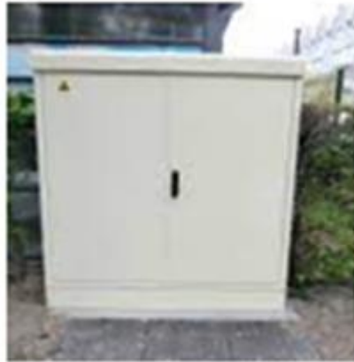
SOUS-REPARTITEUR OPTIQUE (SRO)
